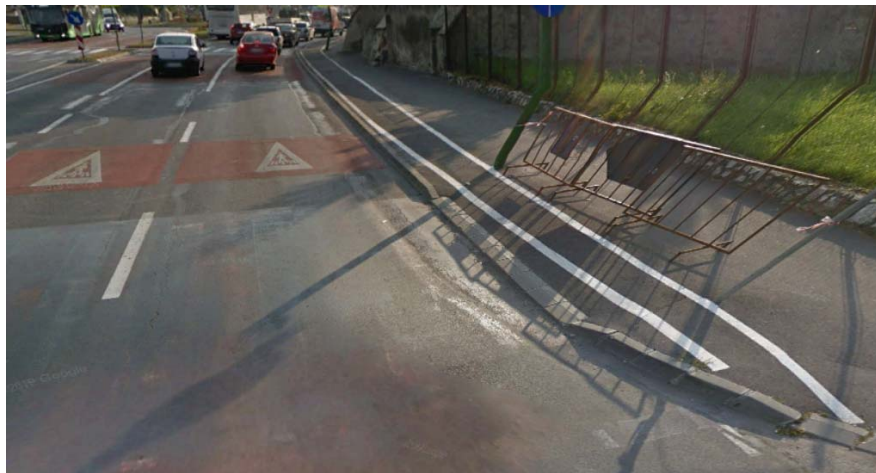
Figura 47: str. Calea Făgăraşului - str.Pictor Ion Andreescu. Pistă biciclete pe trotuar, cu lăţime foarte redusă, fără bordură coborâtă, fără spaţii de siguranţă. Exemplificare
